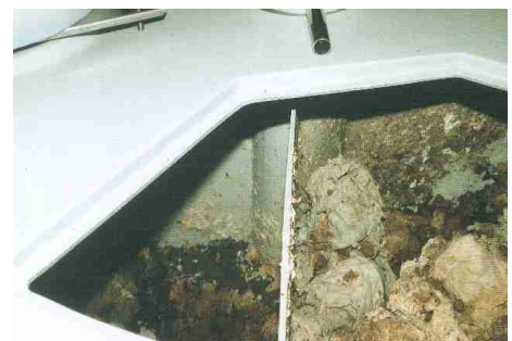
Aquatron 4x300 in Benutzung; links: 1. Kammer nach 2 Jahren Kompostierung, rechts: 4. Kammer mit frischem Material
