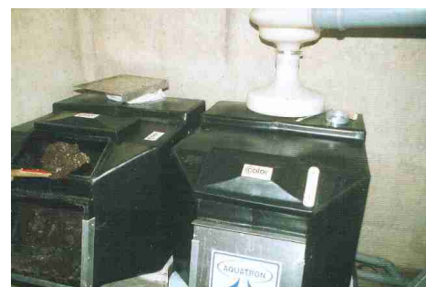
Aquatron 400 mit 2 Kompostbehältern zur wechselseitigen Nutzung, links fertiger Kompost
